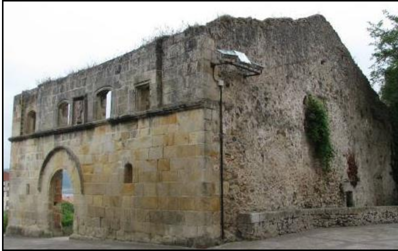
Fig. nº 117. Ruinas del antiguo Hospital de la Concepción de San Vicente de la Barquera.
